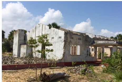
De schade nog steeds zichtbaar
